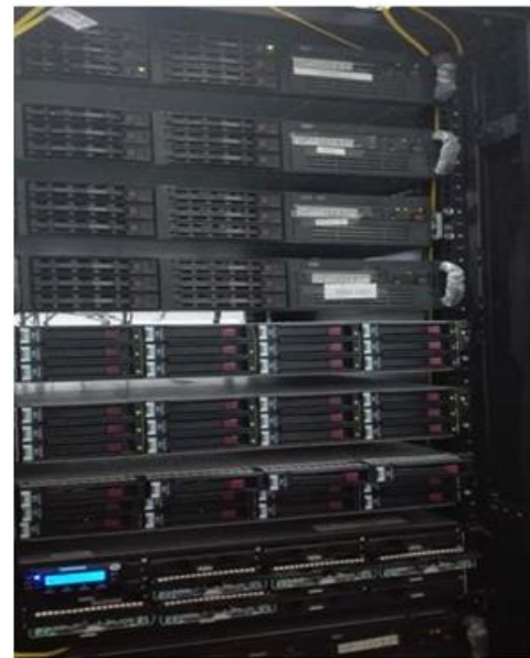
Gambar 6 Server dan storage server di DCU
