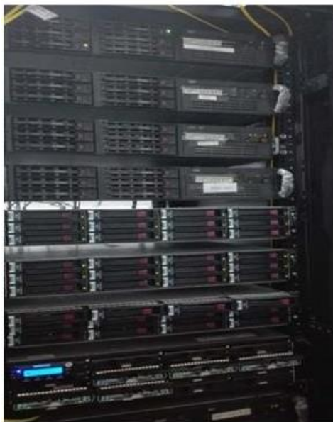
Gambar 6 Server dan storage server di DCU
